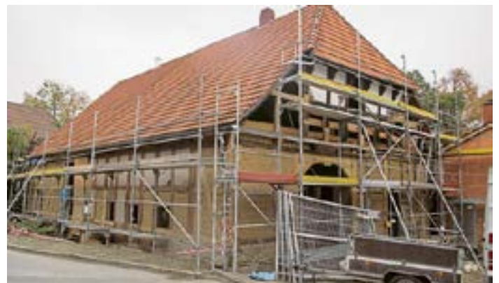
Gut zwei Jahre lang dauerte die Sanierung des zuletzt reichlich heruntergekommenen Baues. Erst nach Abriss eines Anbaus wurde dieses Tor wiederentdeckt.
